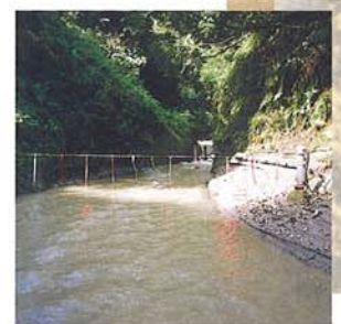
土石流検知センサーとしての施工例
